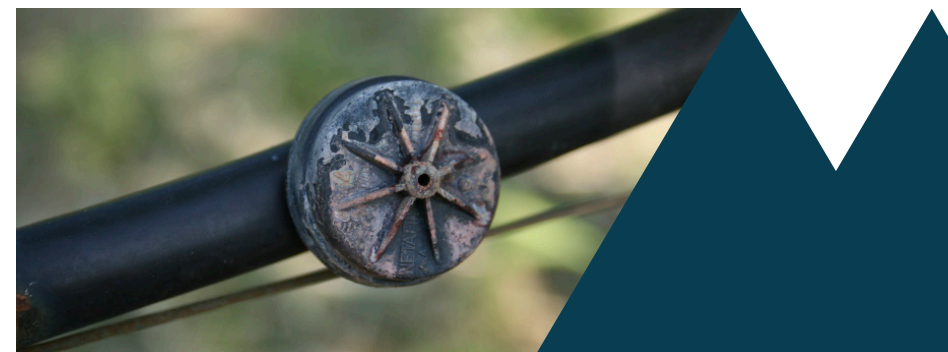
Degoter obstruït a causa d'un mal manteniment de la instal·lació (Foto: ECA Tàrrrega).
